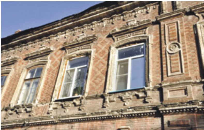
■ Дом купца Россолимо, которому угрожает оштукатуривание
