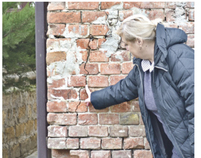
Владелица здания Наталья Дыбова показывает трещины на историческом объекте – торговой лавке Жученкова
