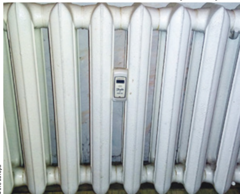
■ У каждого отопительного прибора установлен регулятор теплового потока
