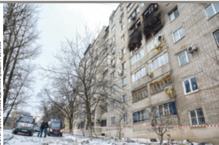
Взрыв газа произошел на пятом этаже многоквартирного дома в Ростове
