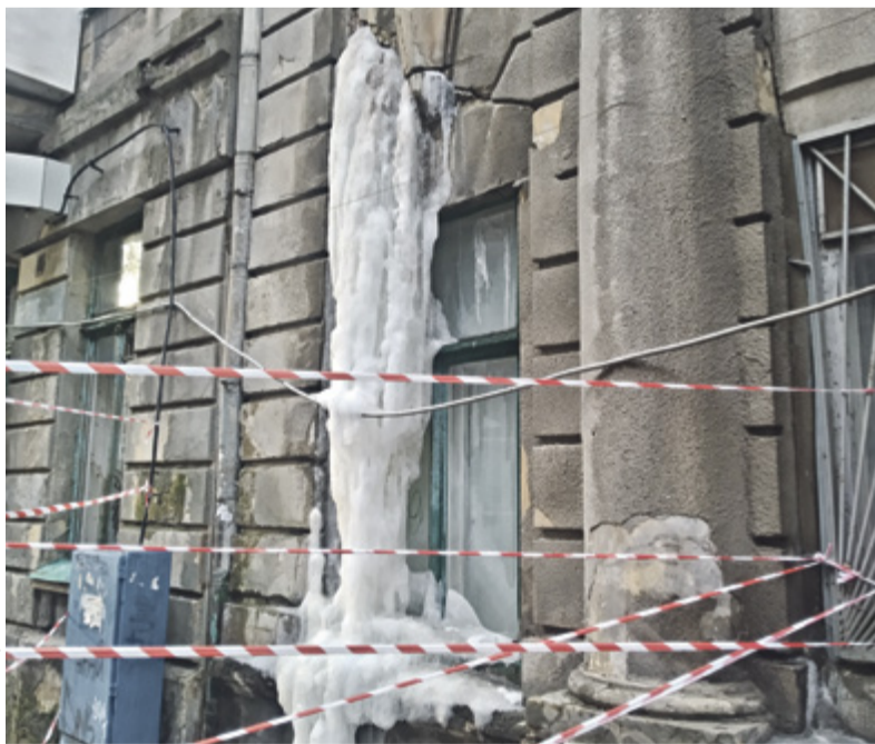
Ледяная глыба разрушает фасад исторического здания
