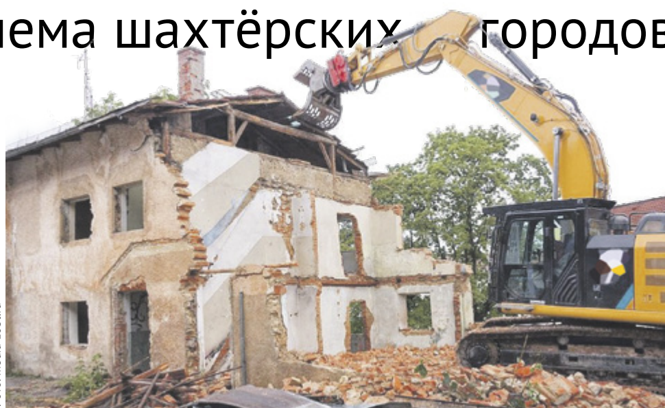
■ После ликвидации шахт и сноса ветхого жилья эти земли могут быть опасны и непригодны для строительства новых домов
