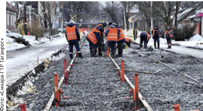
Фото: «Синара-ГТР Таганрог» ■ Весь комплекс работ планируется завершить до конца текущего года
