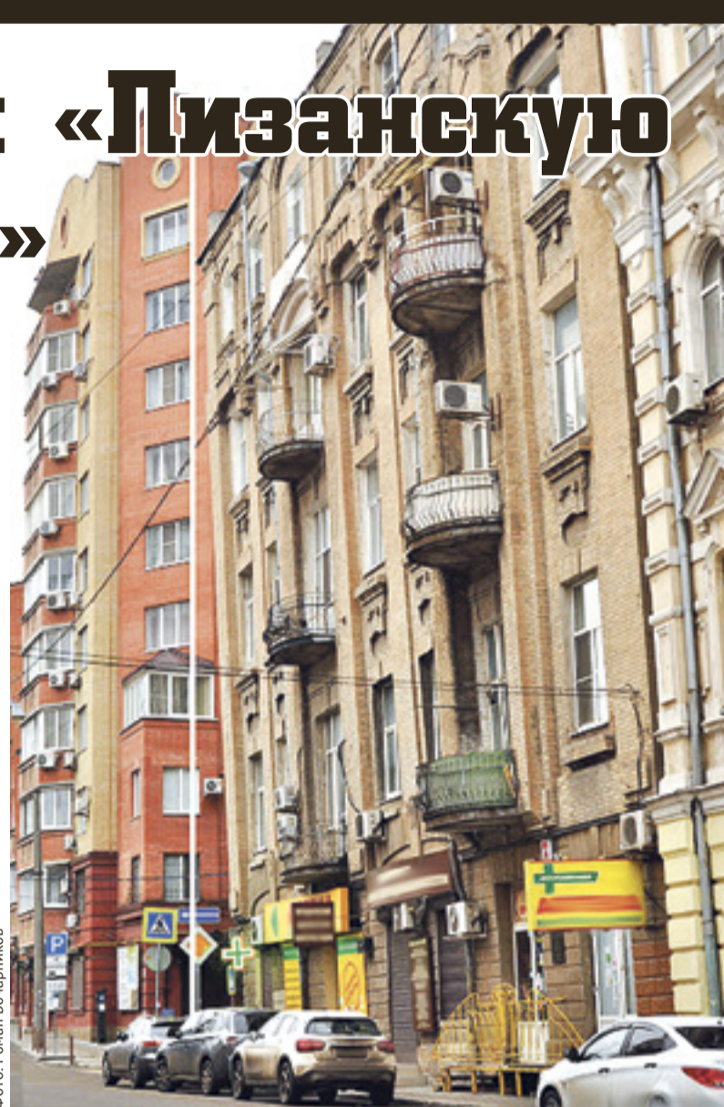
■ Дом Леванидова на углу Шаумяна и Халтуринского недаром прозвали падающим – у здания крен сверх нормы
