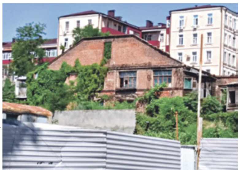
■ Руины дома начальника Ростовского водоканала на Богатынювском спуске
